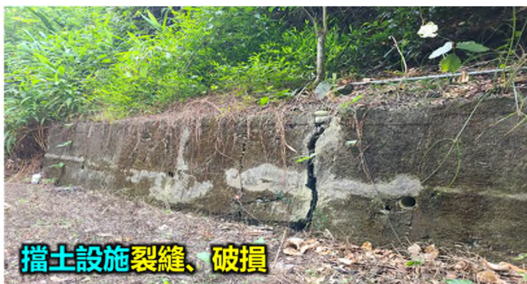
圖 4-26 擋土結構物裂縫、破損病兆特徵示意圖
