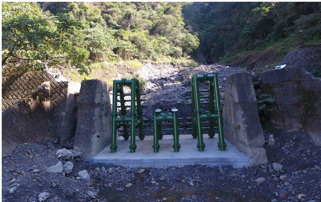
圖 2-1 蘭島溪一號防砂壩之現地探勘照片(陳樹群，2020)。
