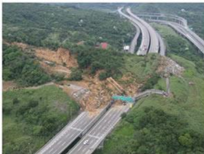
圖 1-2 國道 3 號 3.1K 南下邊坡崩塌 (摘自 Google Map, 2009)
