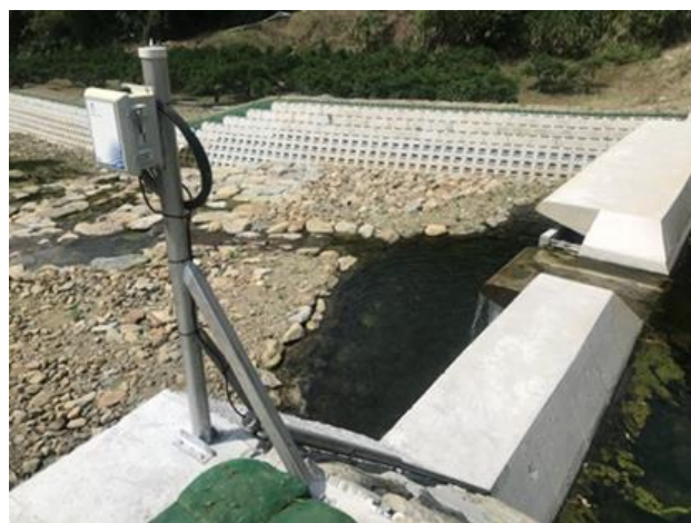
出入流口水位計監測
