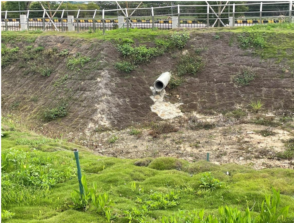
圖 4-21 污水處理廠 - E1 池入水口實照
