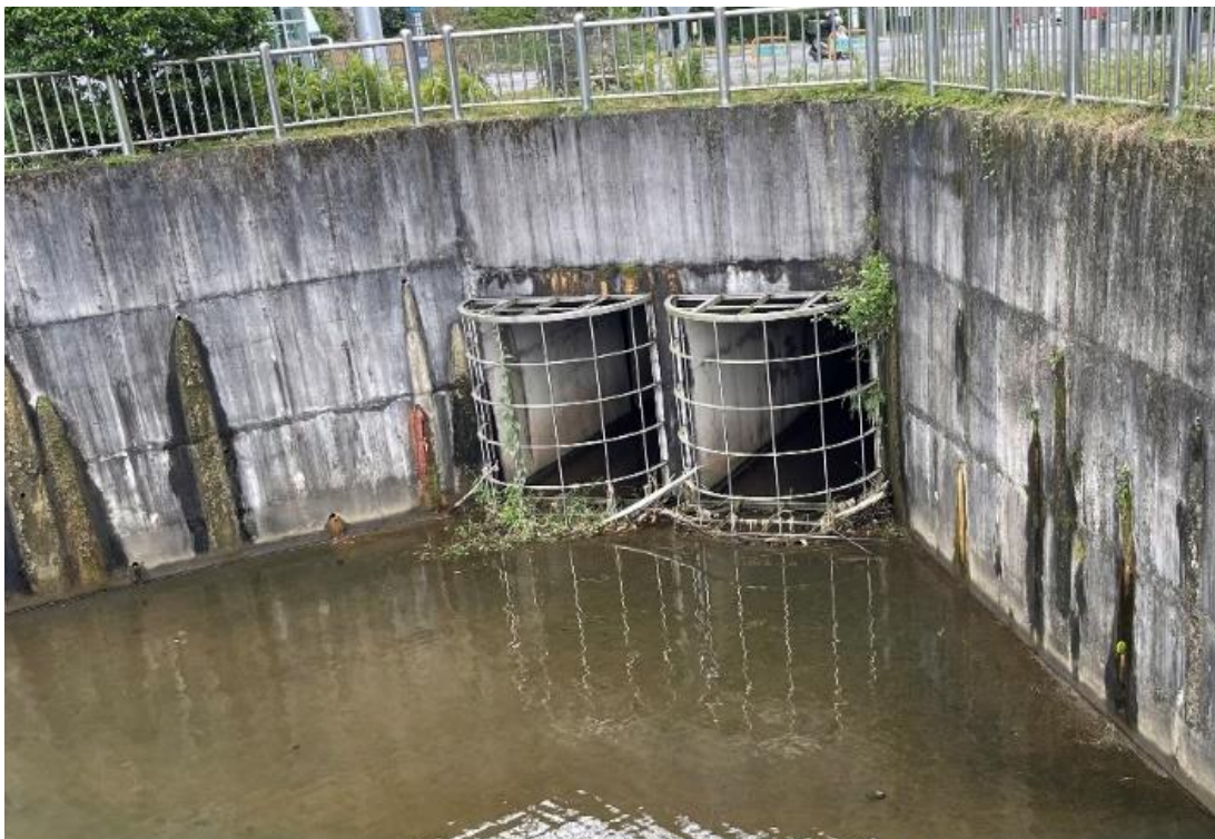
圖 3-6 沉砂設施出水口攔汙柵堵塞及損壞程度檢查
