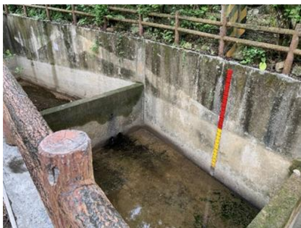
沉砂池內部測尺配合即時影像回傳
