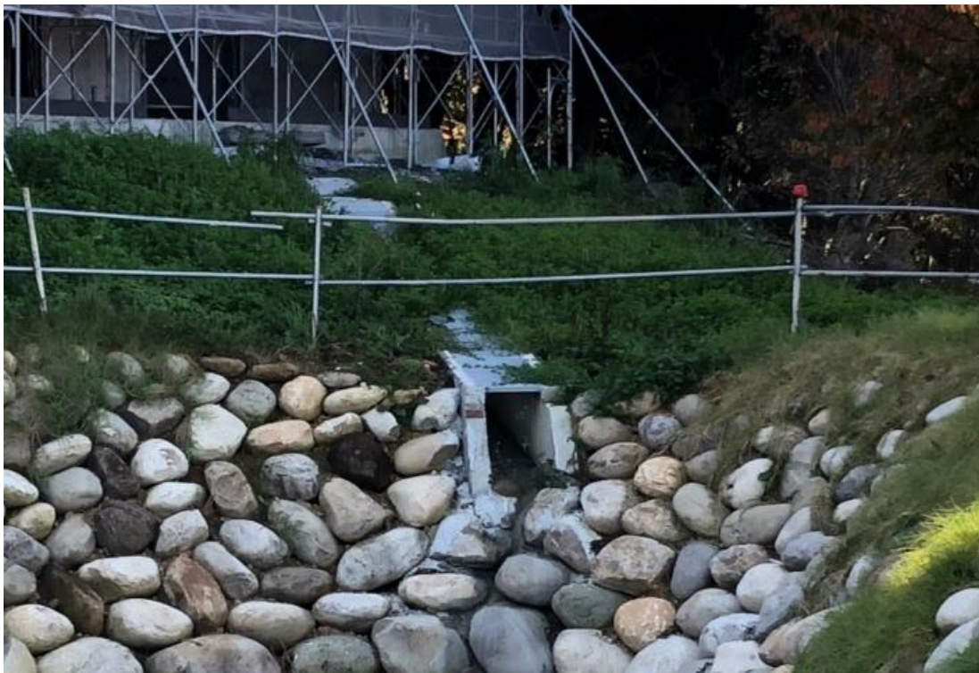
圖 3-4 沉砂設施入水口堵塞及損壞程度檢查
