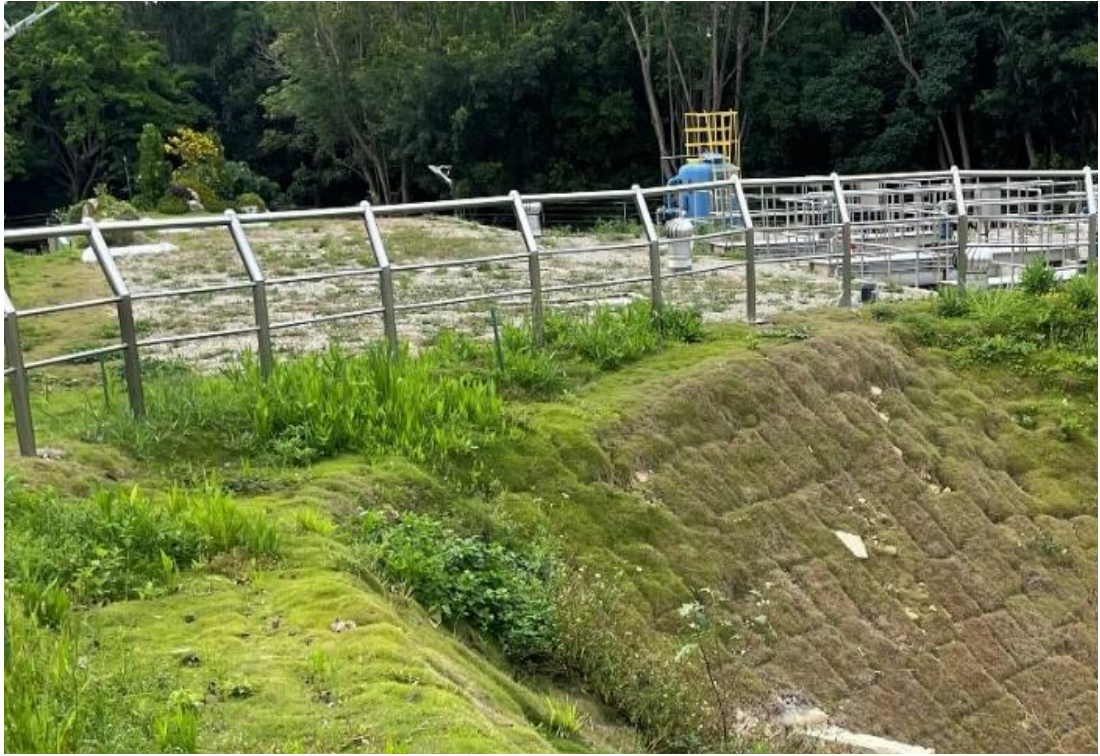
圖 3-5 沉砂設施周圍防護措施老化及損壞程度檢查
