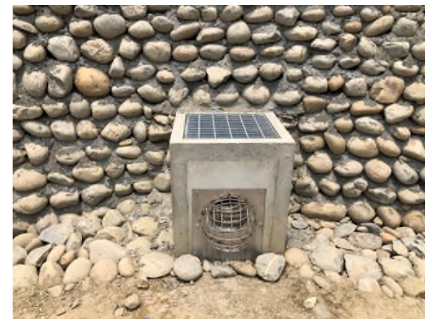
出水口半圓形攔汙設施
