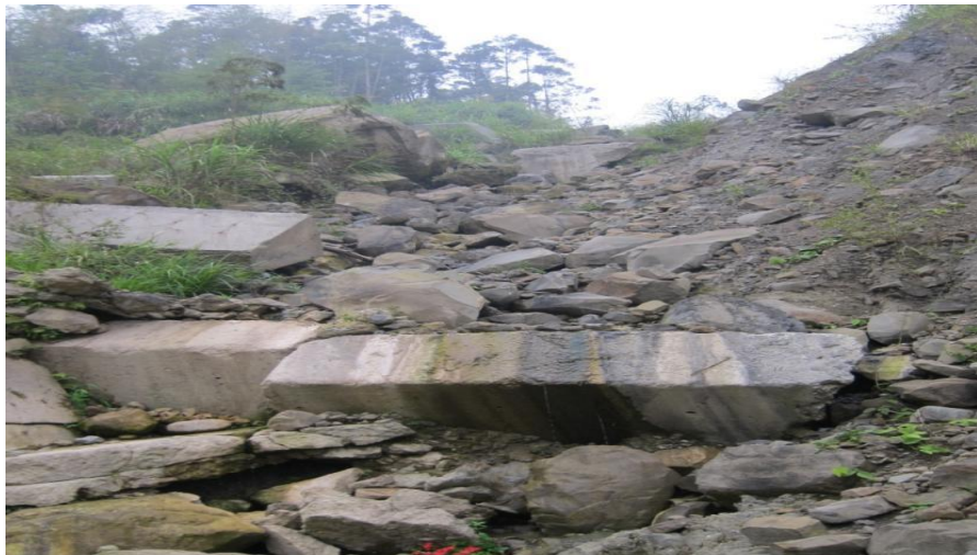
圖 2-5 設施已呈現毀損崩壞形態
