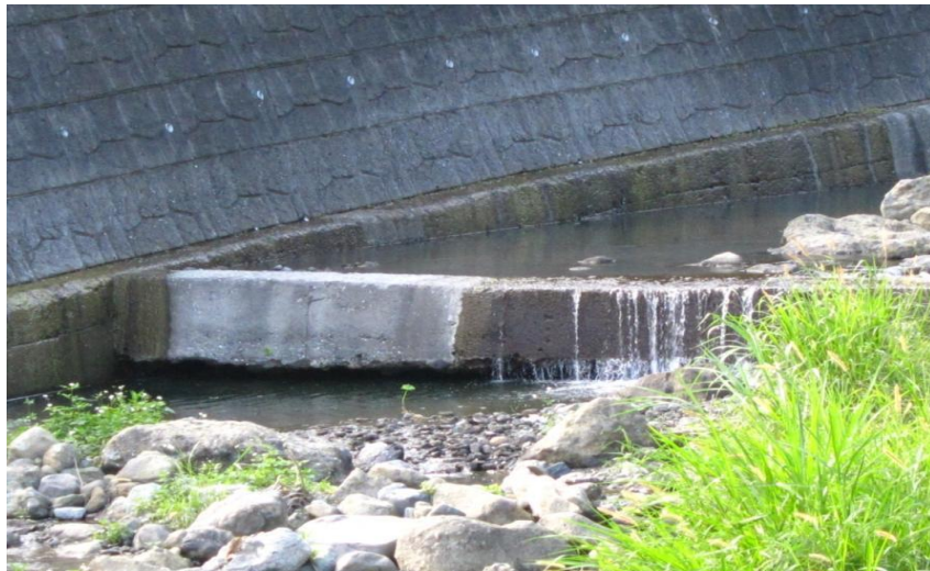
圖 2-3 設施產生淘空破壞形態
