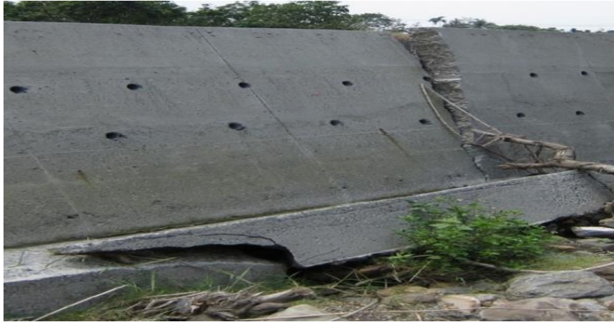
圖 2-4 設施呈現位移之破壞形態
