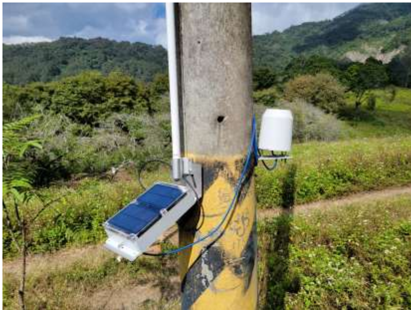
圖 4- 22 明霸克露橋上游 LoRa 發射站安裝地點
