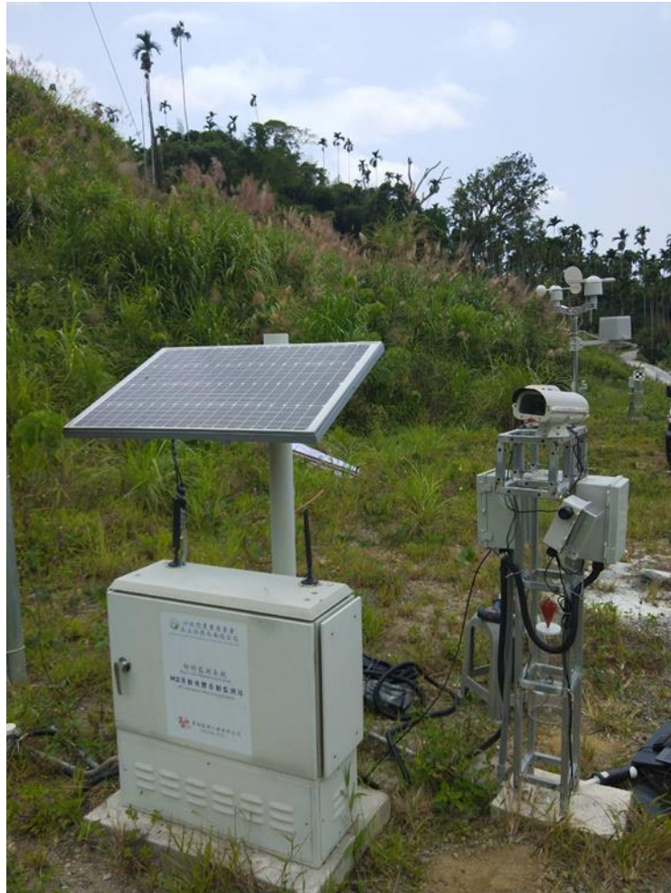
圖 2-36 微氣象站現地架設(嘉義竹崎-中心崙崩塌地)
