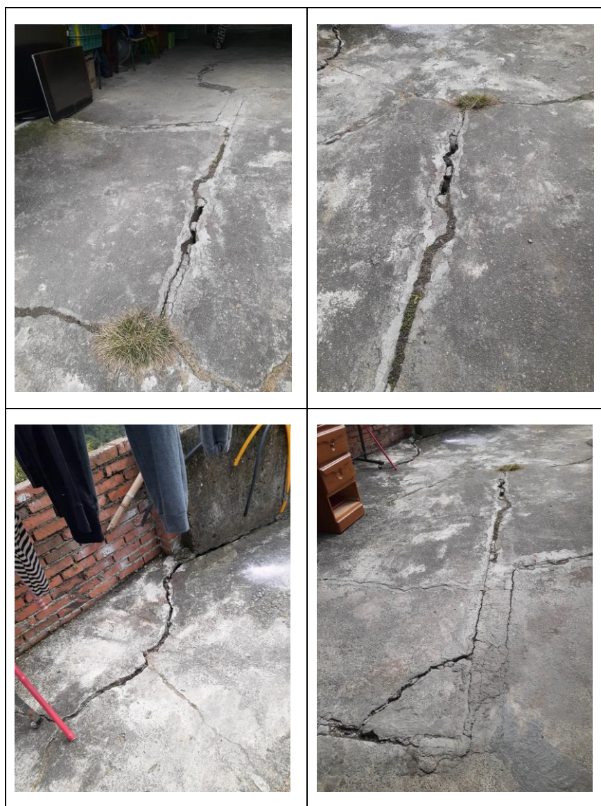
圖附-6 2021 年 11 月 28 日編號 45~47 住屋入口處裂縫現況
