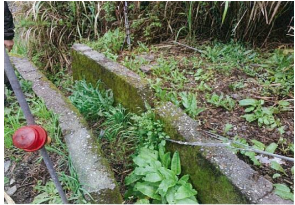
既有洩槽傾斜斷裂
