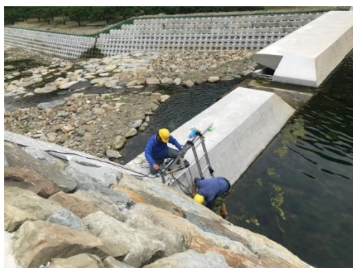
(a) 放置水位計感測器
