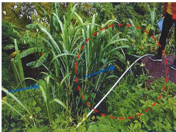
農路基礎崩塌流失
