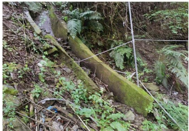
既有洩槽傾斜斷裂
