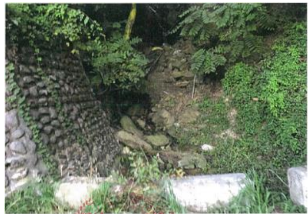
邊坡崩塌及箱涵阻塞
