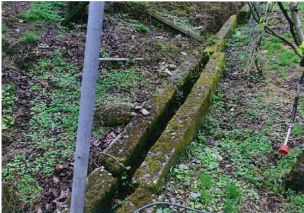
既有洩槽傾斜斷裂
