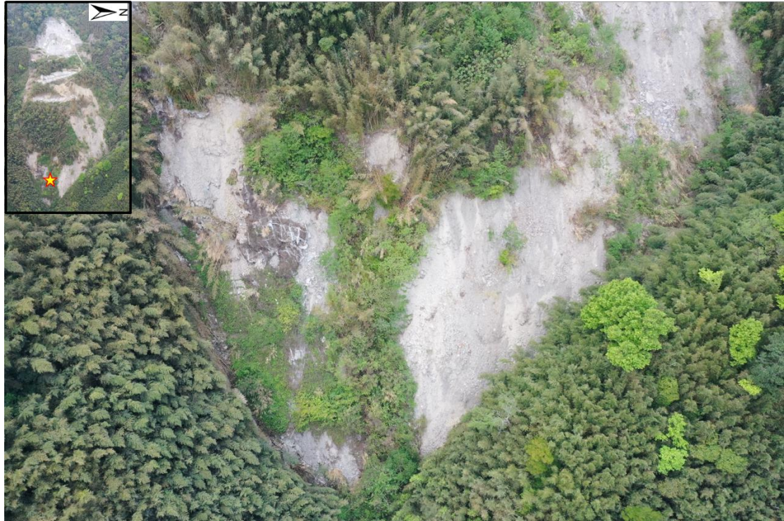
圖 5- 21、坡趾處有大面積現生裸露地與格梁護坡毀損。(拍攝日期 2021/03/30)
