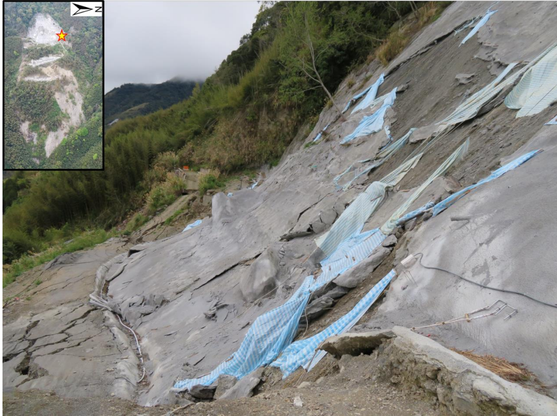
圖 5- 16、邊坡護坡工程已壞損。(拍攝日期 2021/03/08，拍攝方位角 180 度)
