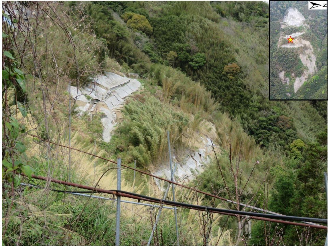
圖 5- 20、邊坡工程有多處毀損。(拍攝日期 2021/03/08，拍攝方位角 0 度)
