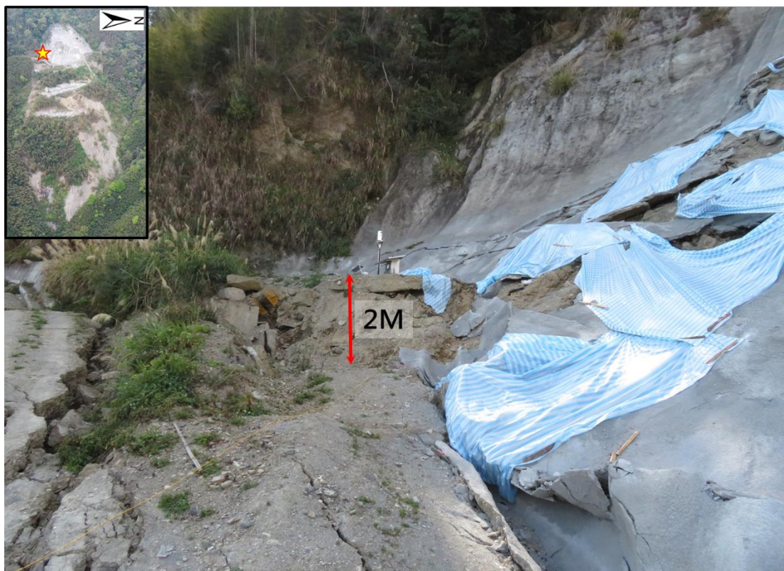
圖 5- 19、子崩崖崖面落差明顯。(拍攝日期 2021/02/23，拍攝方位角 180 度)
