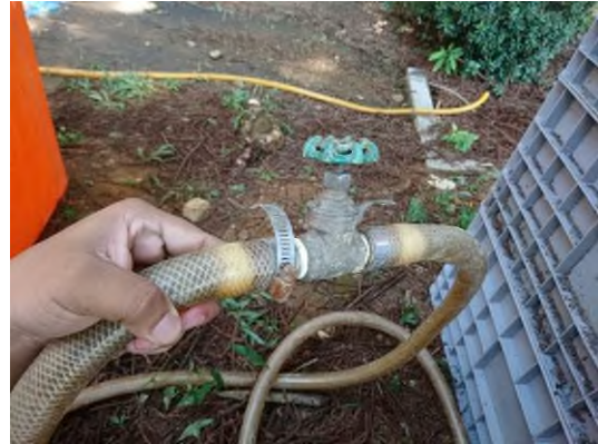
圖 2-29 確認管線均連接妥當
