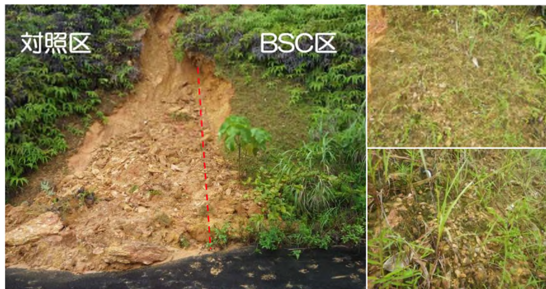
圖 1-6 施作地點後續崩塌效果比較 (富坂峰人，2019)
