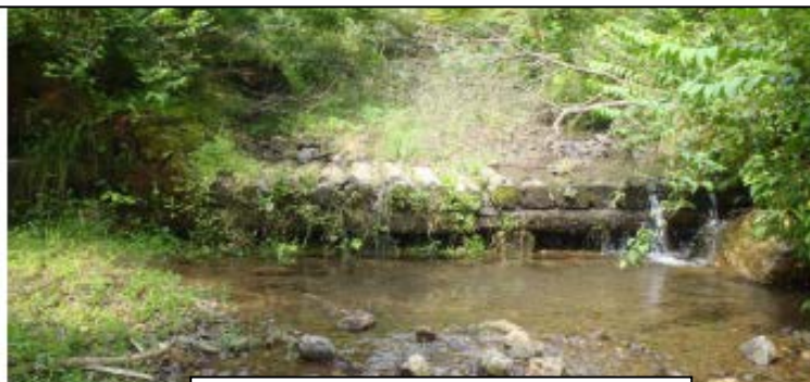
《對策實施前（損傷情況）》
