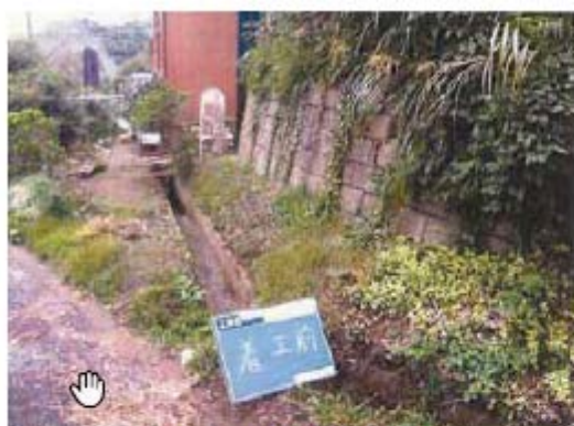
《對策實施前（損傷情況）》
