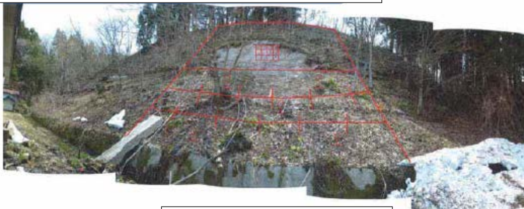
《對策實施前（損傷情況）》
