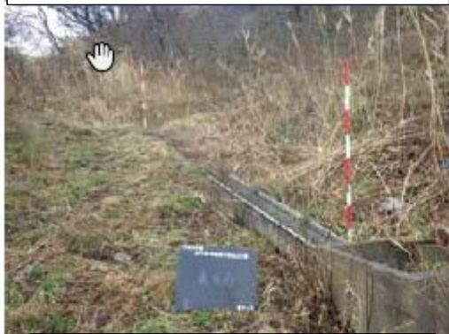
《對策實施前（損傷情況）》
