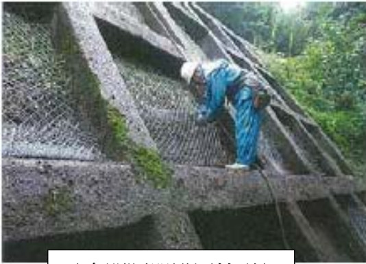
〈多間隔器設置情形〉
