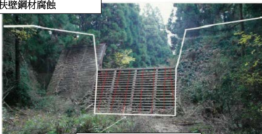
《對策實施前(損傷情況)》
