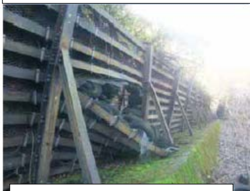
《對策實施前（損傷情況）》
