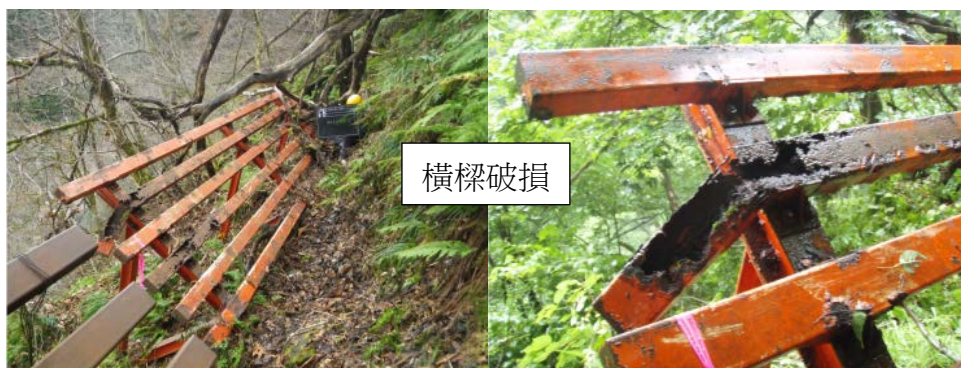
《對策實施前（損傷情況）》
