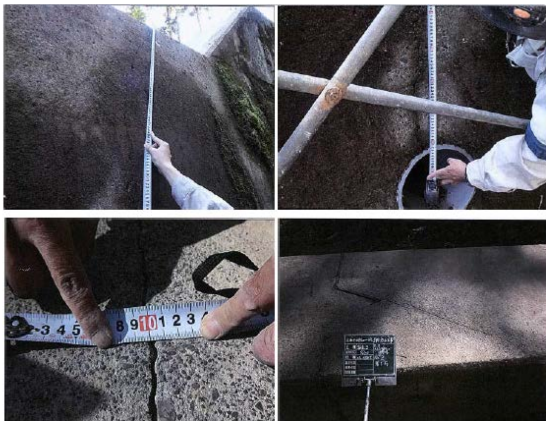
分洪道到堤身下層堤基部龜裂（長 1.8m、寬 3mm）
