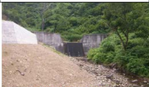
《對策實施前(損傷情況)》
