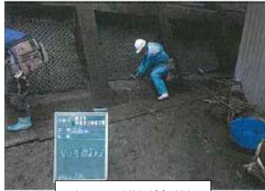
〈VU50 設置情形〉
