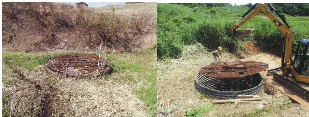
《對策實施前（損傷情況）》
