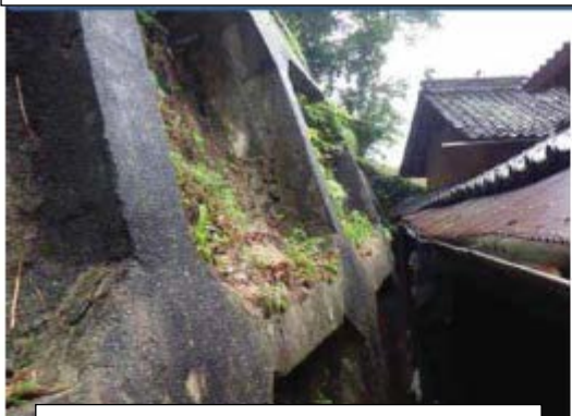
《對策實施前（損傷情況）》
