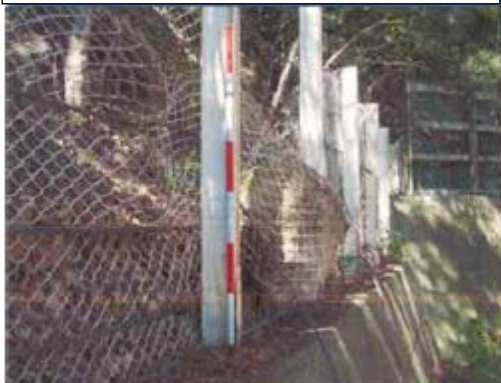
《對策實施前（損傷情況）》
