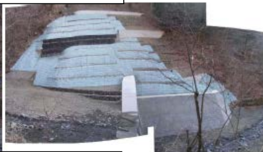
《對策實施前（損傷情況）》
