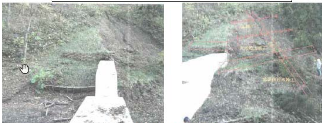
《對策實施前（損傷情況）》
