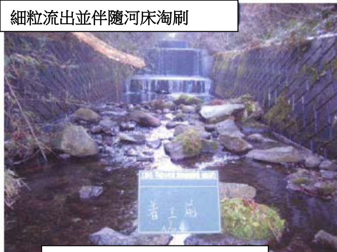
《對策實施前（損傷情況）》
