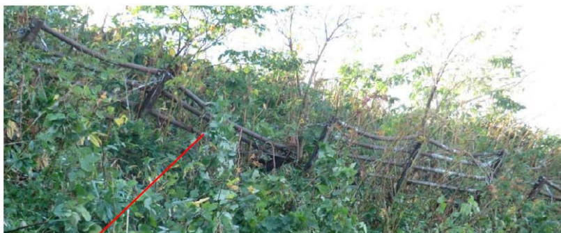
現有雪崩預防柵欄因腐朽造成的破損
