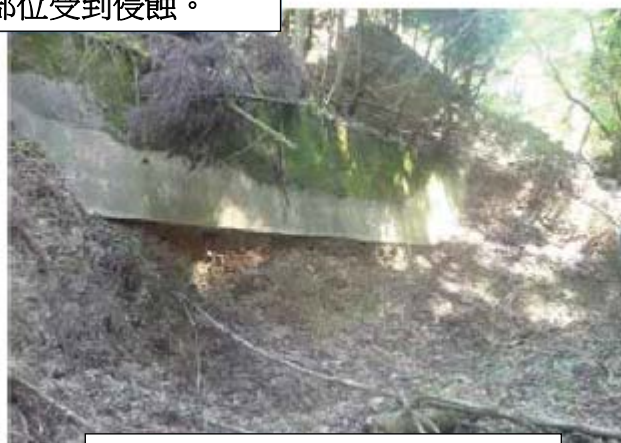
《對策實施前（損傷情況）》
