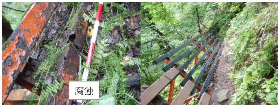
《對策實施前（損傷情況）》
