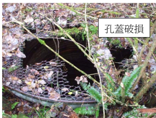
《對策實施前（損傷情況）》
