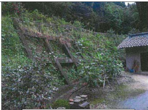
《對策實施前（損傷情況）》
