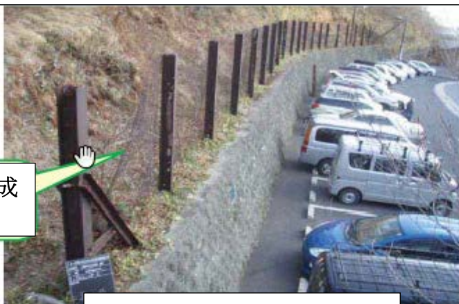
《對策實施前（損傷情況）》
