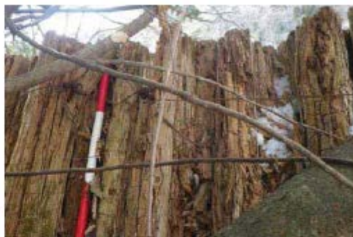
《對策實施前（損傷情況）》
