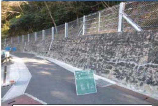
《對策實施前（損傷情況）》
