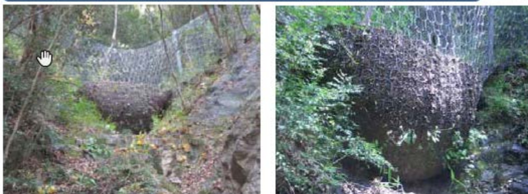
《對策實施前（損傷情況）》
