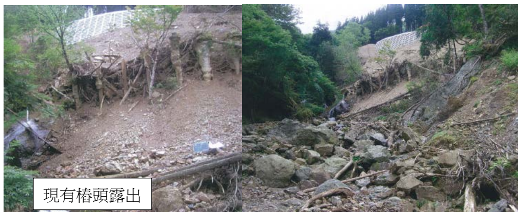
《對策實施前（損傷情況）》
