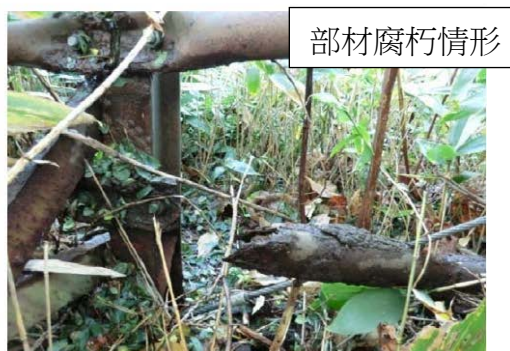
《對策實施前（損傷情況）》
