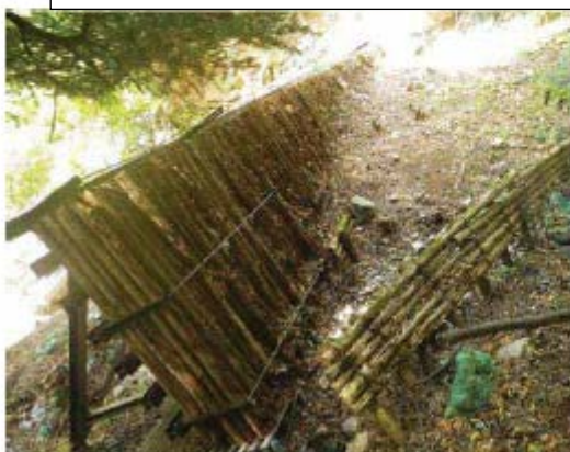
《對策實施前（損傷情況）》
