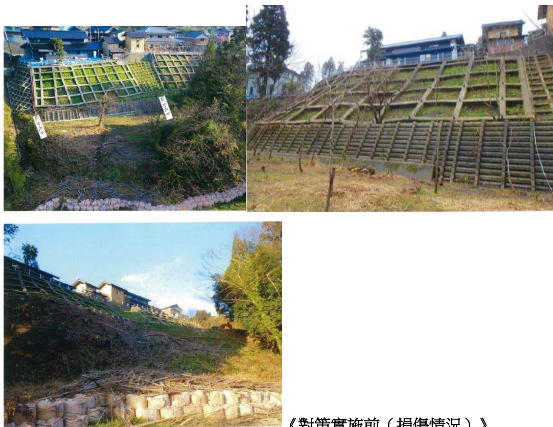
《對策實施前（損傷情況）》
