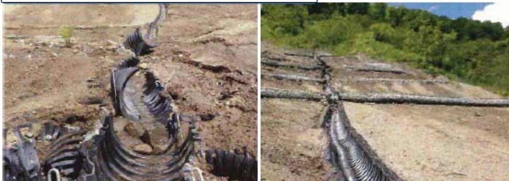
《對策實施前（損傷情況）》
