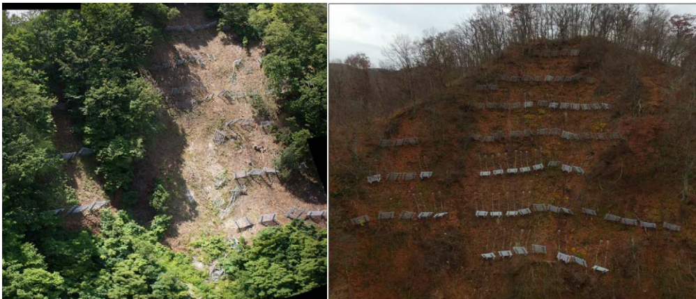
《對策實施前（損傷情況）》
