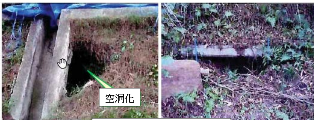
《對策實施前（損傷情況）》
