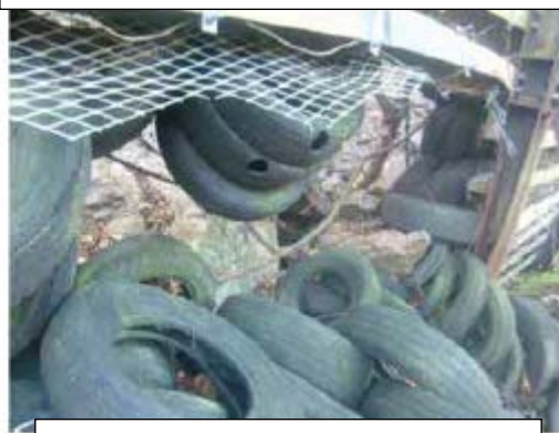
《對策實施前（損傷情況）》
