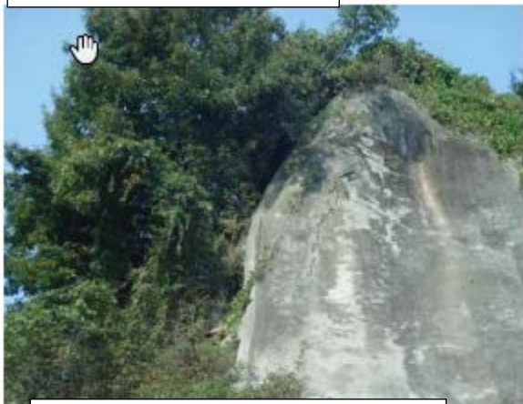
《對策實施前（損傷情況）》
