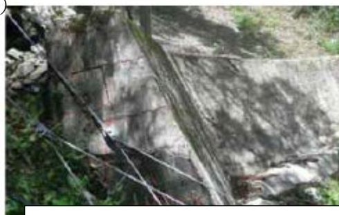
《對策實施前（損傷情況近照）》
