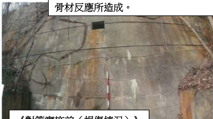
《對策實施前（損傷情況）》
