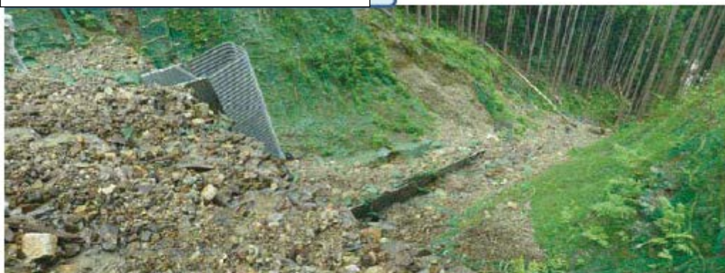
《對策實施前（損傷情況）》
