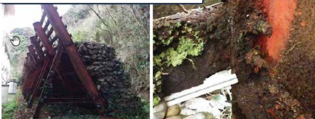
《對策實施前（損傷情況）》
