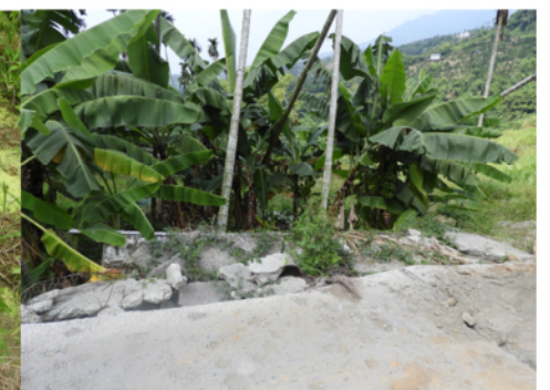
9.道路損壞情形 (E=207640.39, N=2598768.55)
