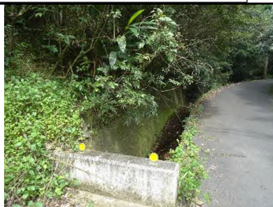
照片 2 崩塌緊鄰河道。
