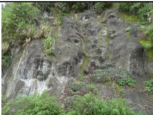
照片 3 邊坡旁有疑似逆向坡發生落石，坡面上有噴漿護坡。
