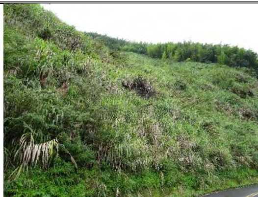
照片 2 崩塌及堆積區現況，坡面上已長滿植生。
