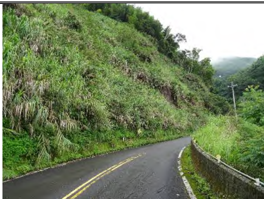
照片 1 崩塌底下即為主要聯絡道路，以及電線桿。
