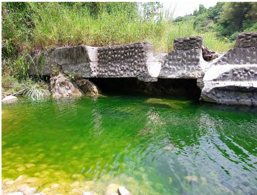
圖 1-2 固床工下游基礎淘空裸露
