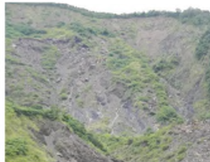
G. 編號A位置近拍，崩塌邊坡上緣發現疑似岩層斷層錯動痕跡，岩層局部有擾動及破碎情形。
