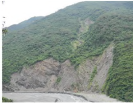
A. 來社溪右岸來義鄉內社聚落北側之河岸邊坡受河流轉彎攻擊侵蝕崩塌情形，主要為板岩碎屑崩塌。
