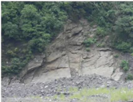
B. 編號A下游右岸板岩或硬頁岩的岩層裸露邊坡，劈理呈 N30^{\circ}\sim 50^{\circ}E/30^{\circ}\sim 40^{\circ}SE ，且為順向坡地形。
