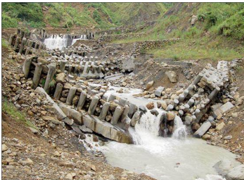
圖 1-1 水工結構物毀損之實際案例。(上) 桃園市復興區之巴陵壩 (北區水資源局, 2007); (下) 九份二山堰塞湖溢洪道之梳子壩 (照片來源: 自由時報, 2008, 記者佟振國攝)
