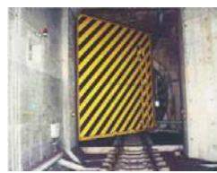
隧道內防水閘門
