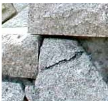
石塊裂開、表面破損，產生不安定感
