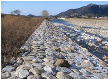
照片-2-6 香川縣 土器川 低水流量護岸為弧頂
