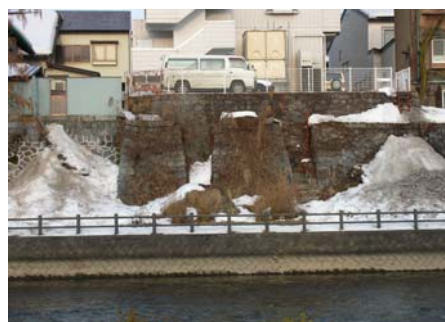
照片-2-2 岩手縣盛岡市、北上川砌石構造物
