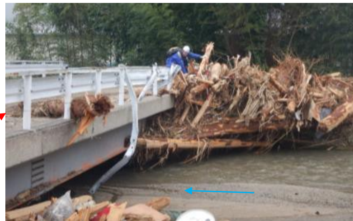
河床上升、橋樑堆積漂流木
