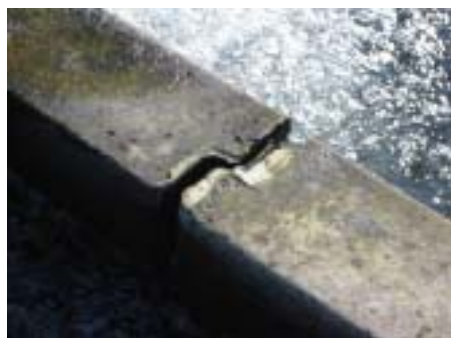
＜魚道接縫出現裂縫、漏水的魚道＞
