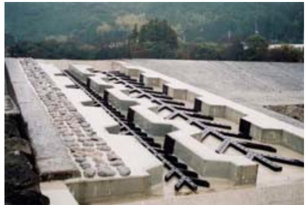
舟通型魚道底部角材使用H型鋼
