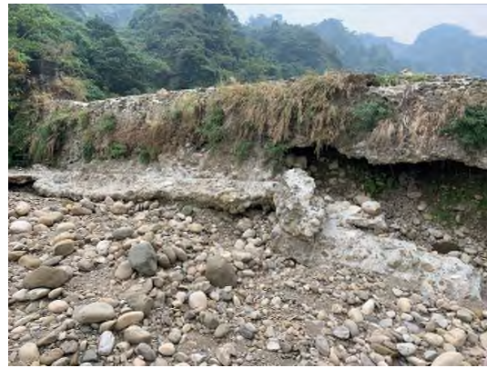
(b) 基礎淘刷、錯動、表面磨損
