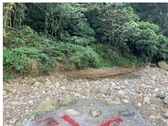
(f) 左側護岸毀損
