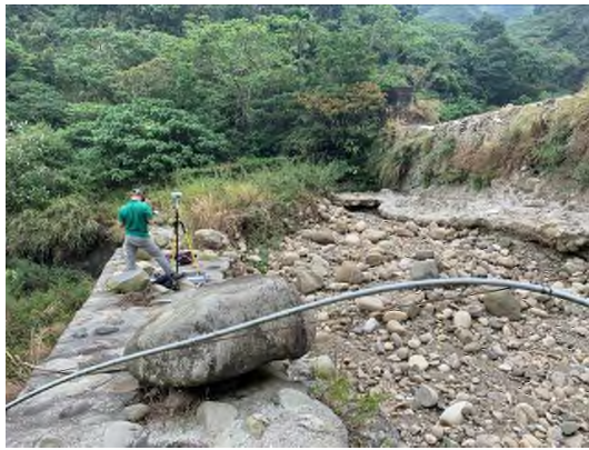
(a) 消能池毀損
