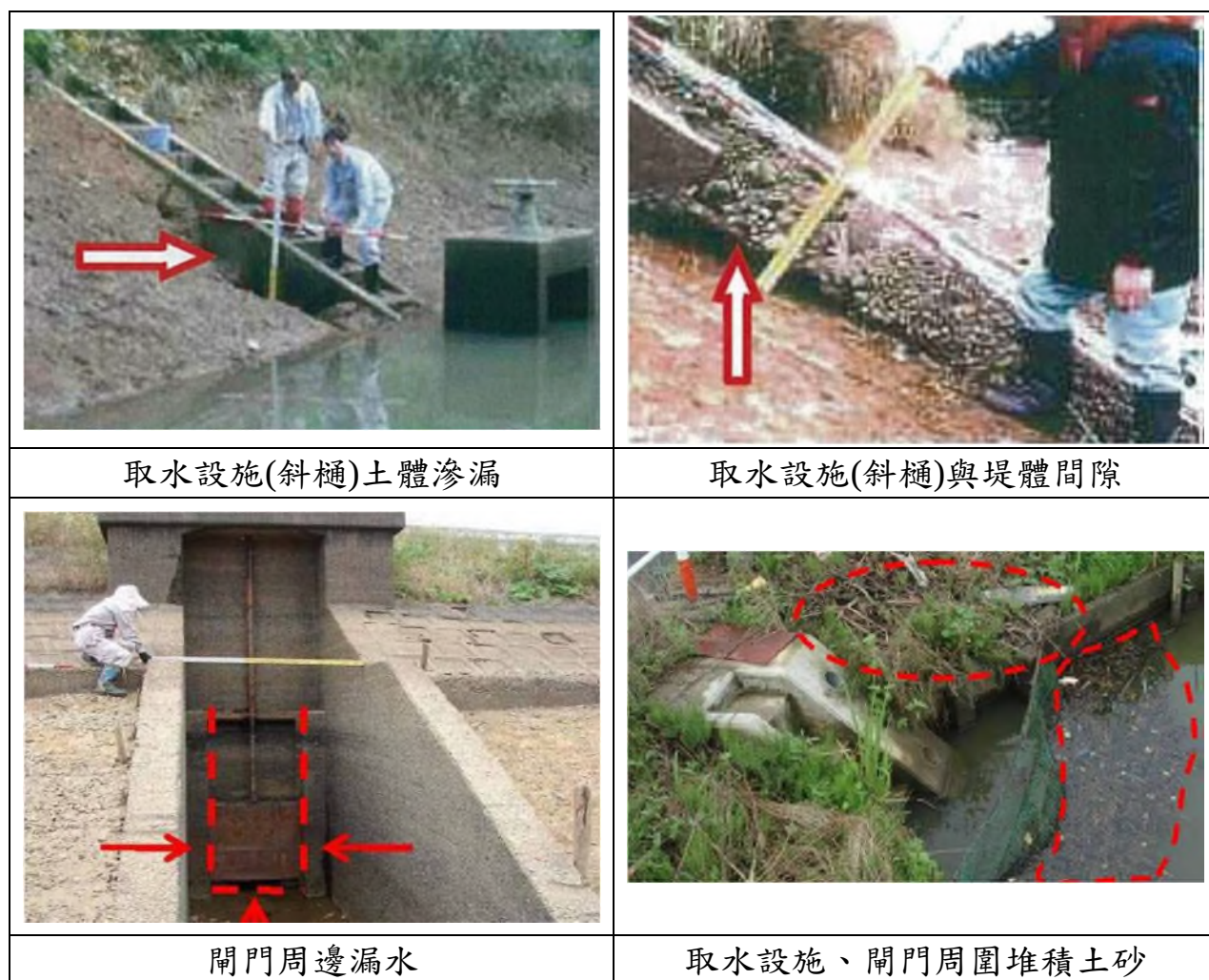
圖 2-21 農塘損壞案例-取、排水設施損傷 (2) (農林水產省，2015)
