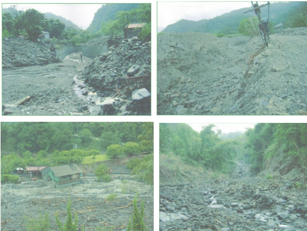
照片 5-10 舊潭 2 號橋野溪土砂災害現況
