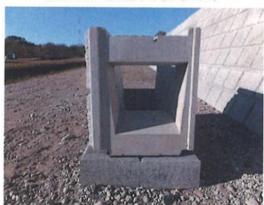
預鑄混凝土塊護岸單體 (側面)
