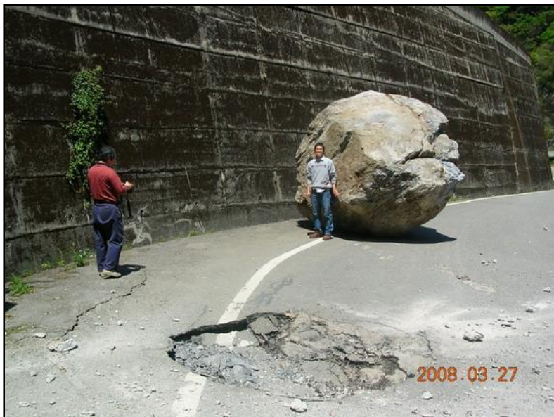
山區落石造成道路受損與阻斷 (宜蘭臺7線)
