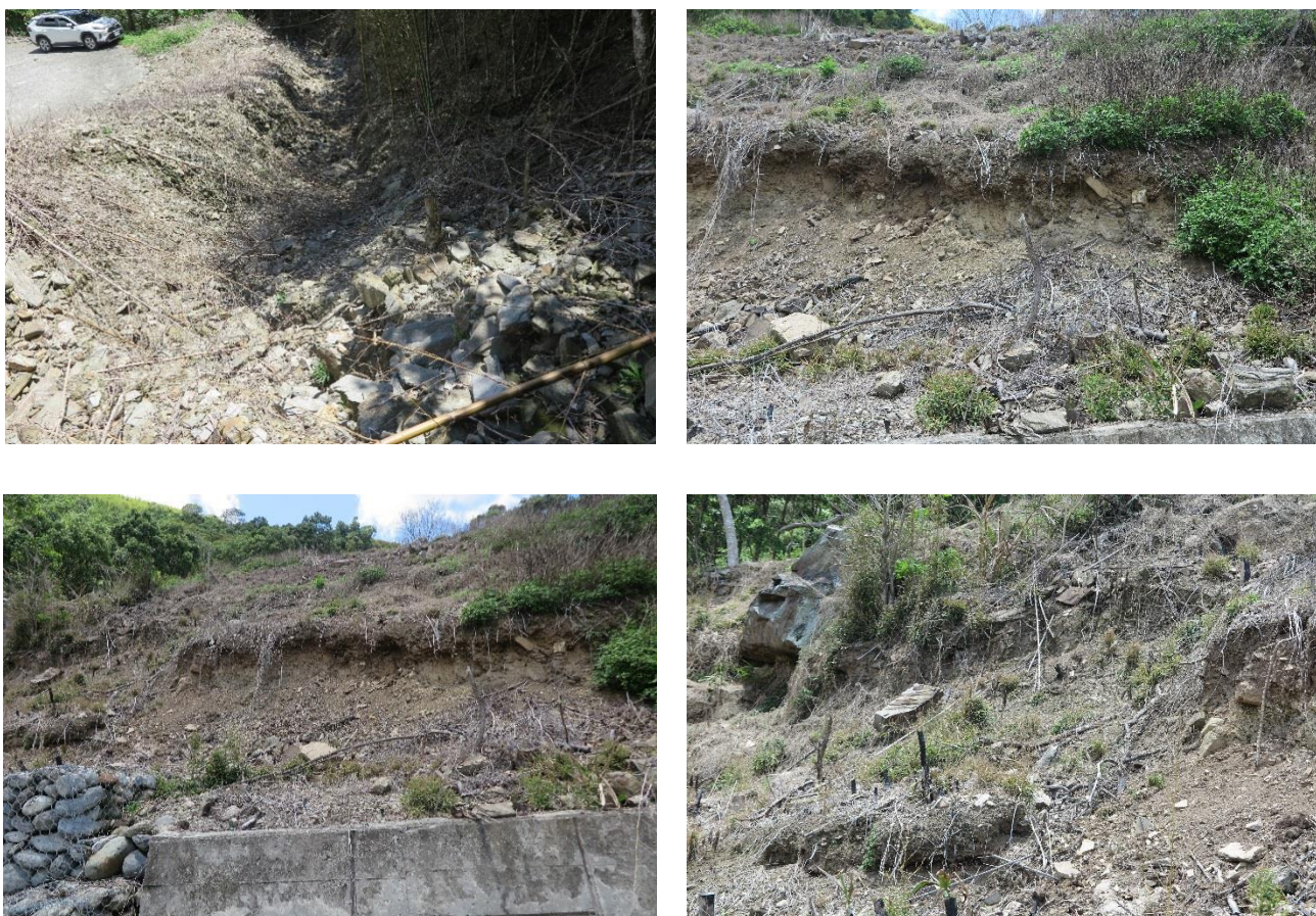
圖 5-6 C01 研究區內坡面型土石流中下游土石堆積現況
