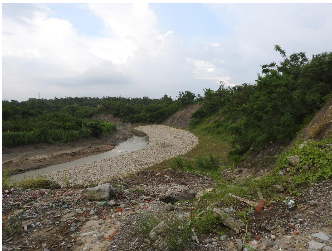
圖 19 古亭里南勢地區擋土牆沖毀以及鵝卵石護岸
