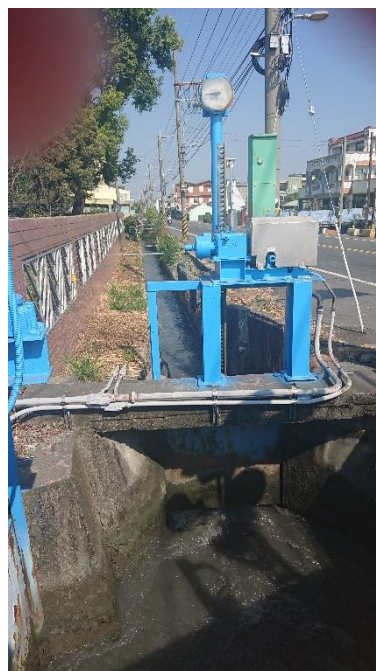
圖 4-47 電動梯桿式閘門(形式較小)
