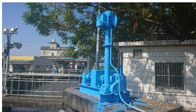
圖 4-41 第一制水門電動式水閘門
