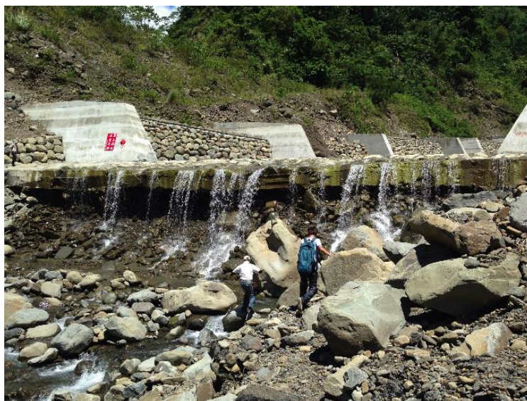
照片 1-1 防砂壩下游河床沖刷現象(下切約 5.0 公尺)
