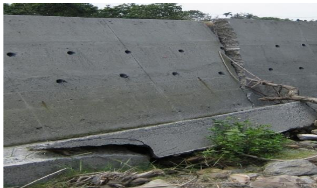
圖 2-2 設施呈現位移之破壞形態
