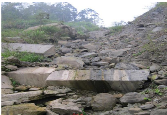
圖 2-3 構造物已呈現毀損崩壞形態
