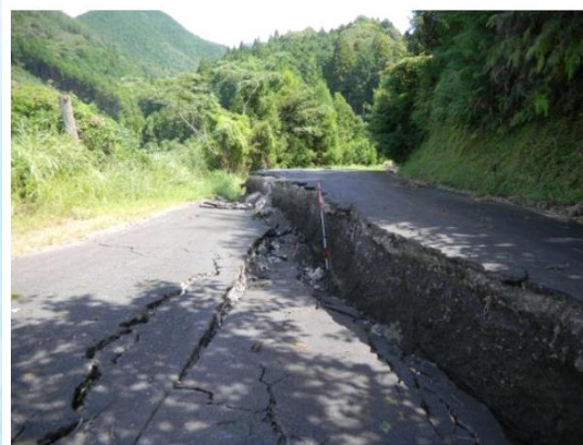
写真-5. 2. 31 市道を横断する亀裂および段差
