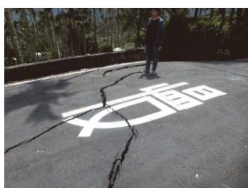
主要道路出現張力裂隙 Tension crack on main road
