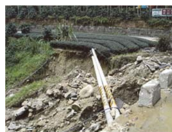
主要道路出現傾倒破壞 Slope failure of main road
