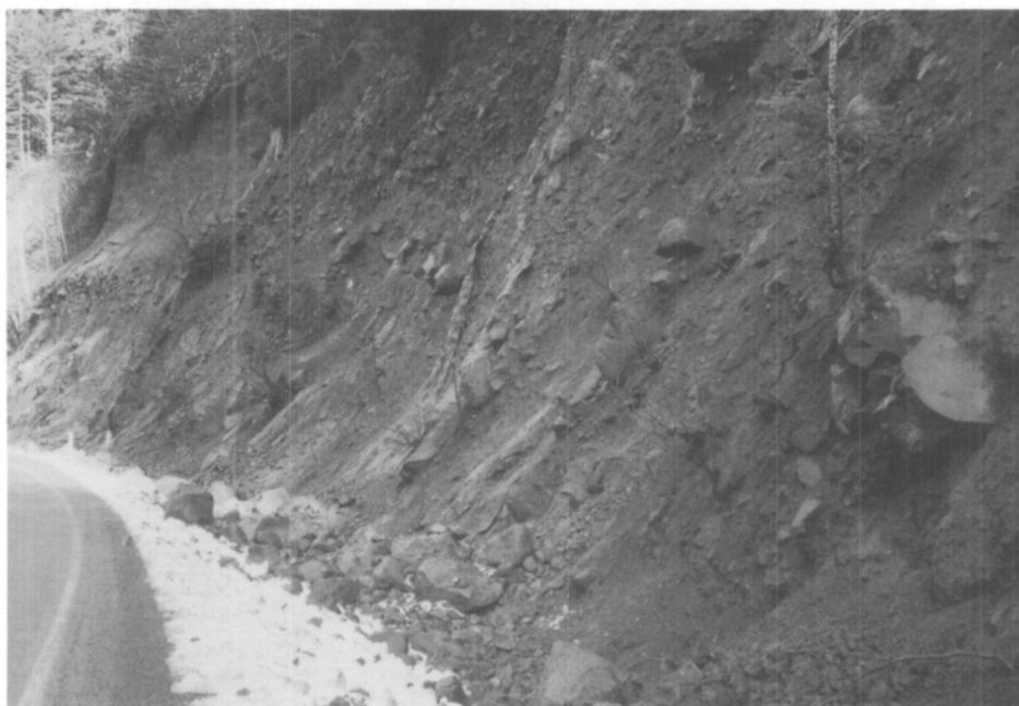
圖 5.25：過度陡峭的土壤/岩石邊坡
