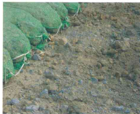
基礎表面未清除
