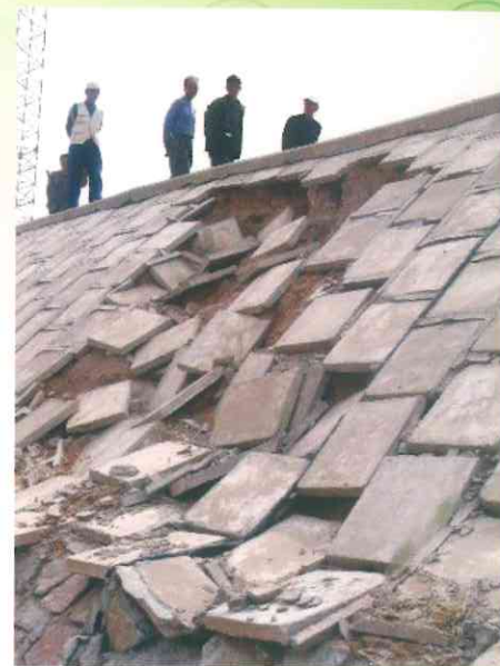
護坡施作不當造成倒塌
