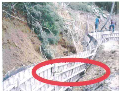
模板組立不良
