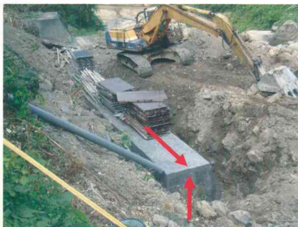
未設置施工縫
