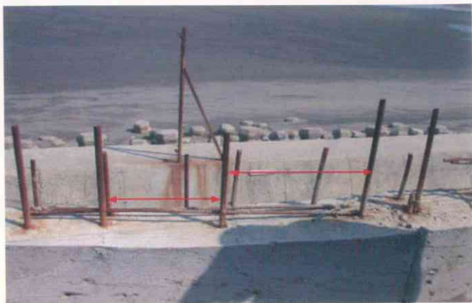
鋼筋豎筋間距不足
