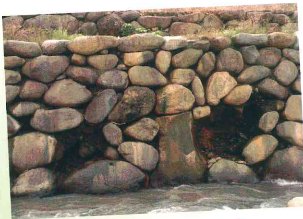
砌築不良部分損壞
