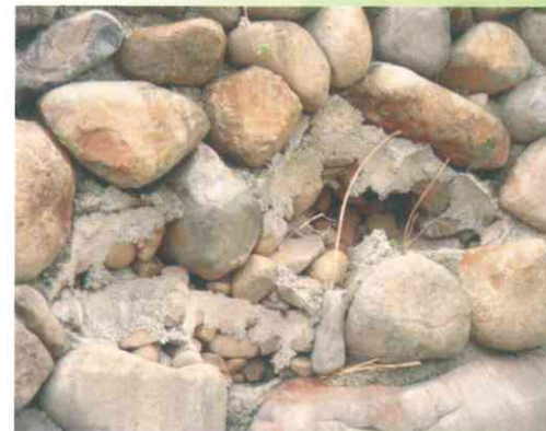
塊石排列不良
