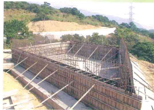
未設置防護措施
