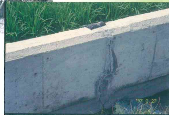
施工縫施工不良
