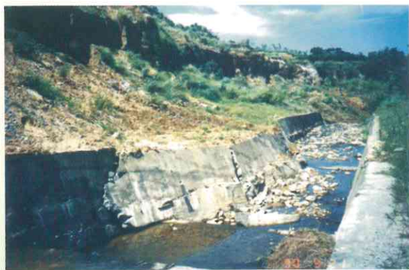
基礎深度不足護岸崩塌
