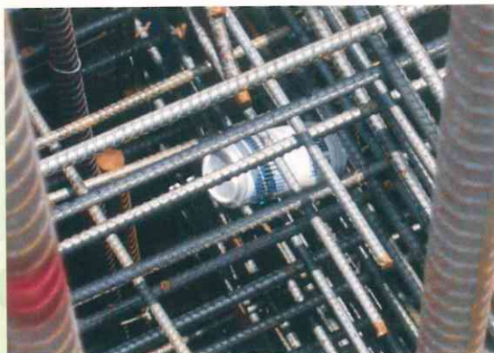
綁紮時未清除雜物
