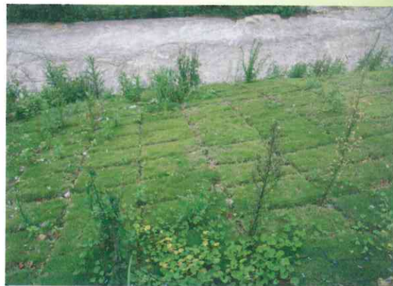
草皮鋪植雜草入侵嚴重
