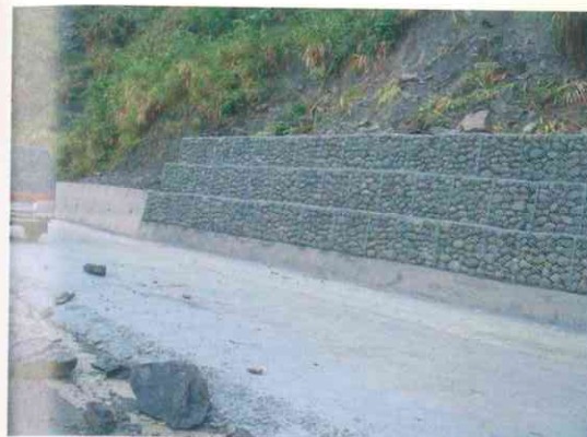
未設置伸縮縫
