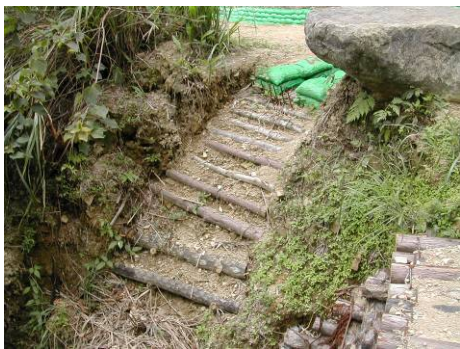
照片 4-33 截水溝出口消能設施
