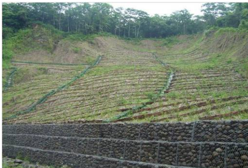
照片 4-58 箱籠擋土牆(台北雙溪)
