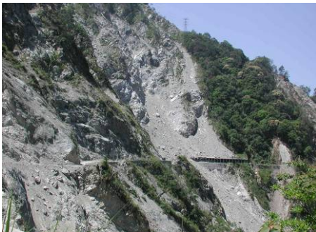
照片 1-2 中橫公路邊坡崩塌地
