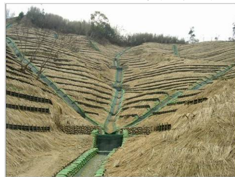
照片 4-39 土壤袋排水設施
