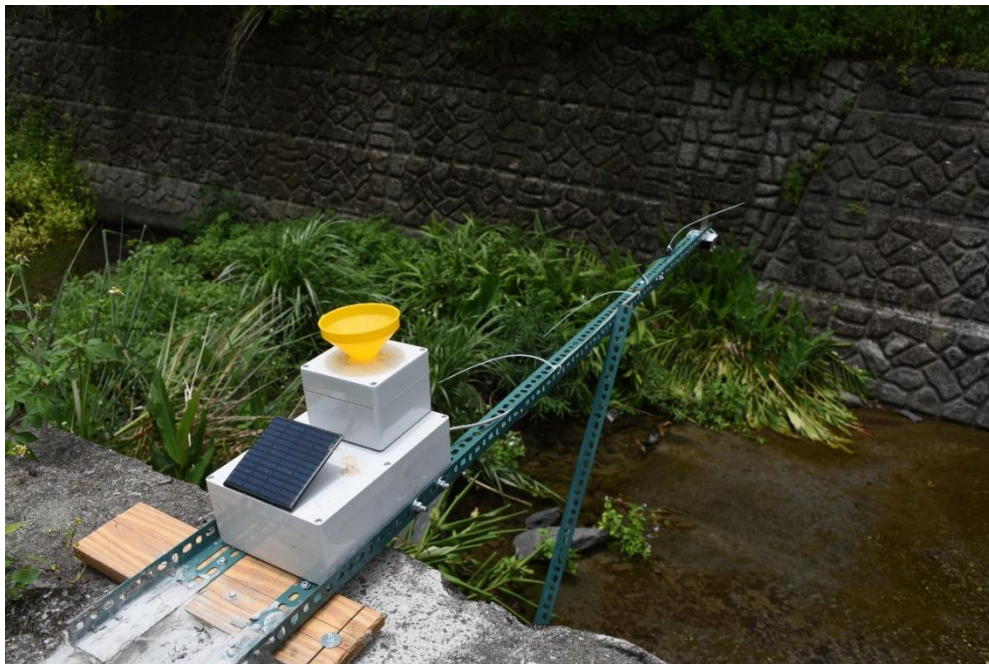
圖 4-35 草涌儀器安裝近照
