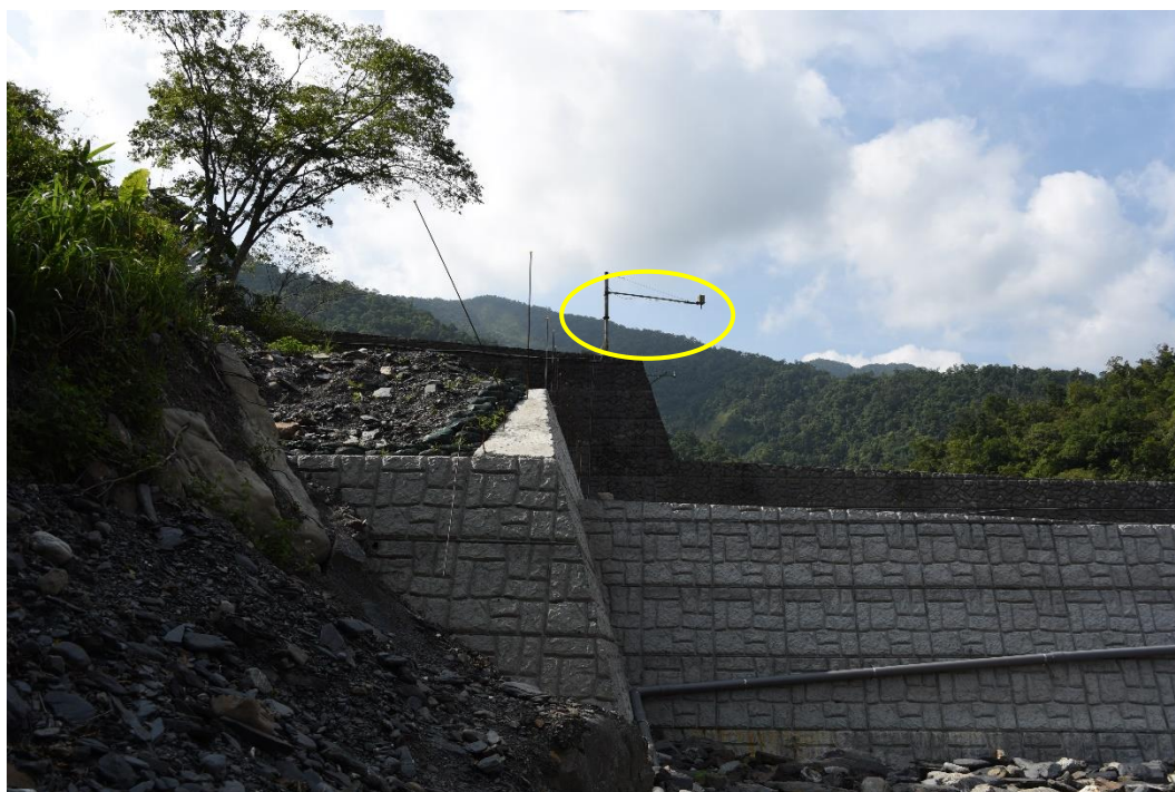
圖 4-20 寒溪(番社坑溪)儀器安裝遠照(一)
