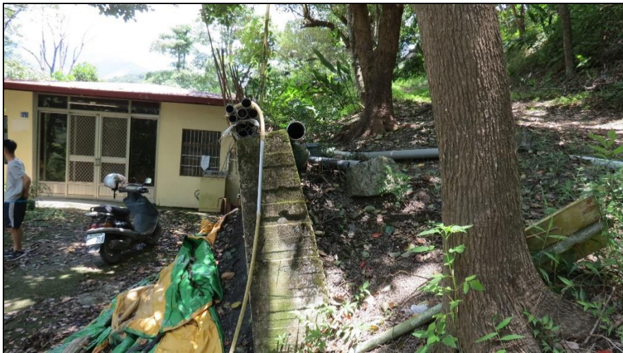
圖 26 竹林 28 號後方擋土牆傾斜
