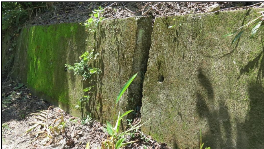
圖 30 竹林 28 號道路擋土牆破裂
