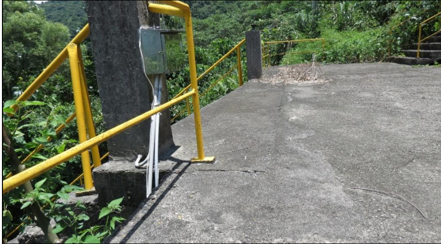
圖 25 竹林 28 號建物地基龜裂但經修補
