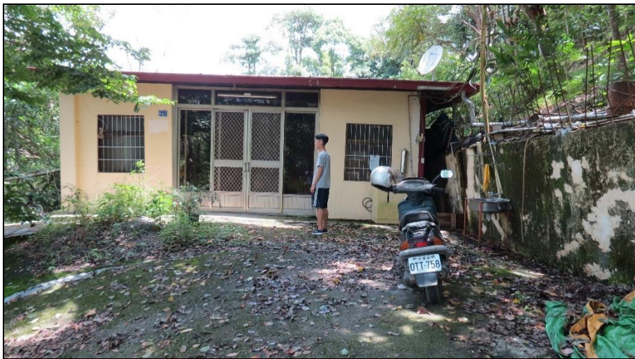
圖 28 竹林 28 號建物緊鄰邊坡
