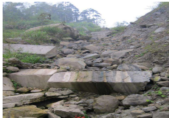
圖 4-8 構造物已呈現毀損崩壞形態
