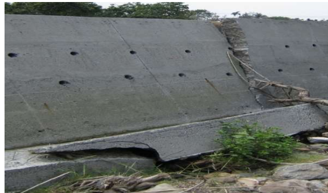
圖 4-7 設施呈現位移之破壞形態
