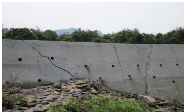
圖 4-3 結構物產生裂縫形態
