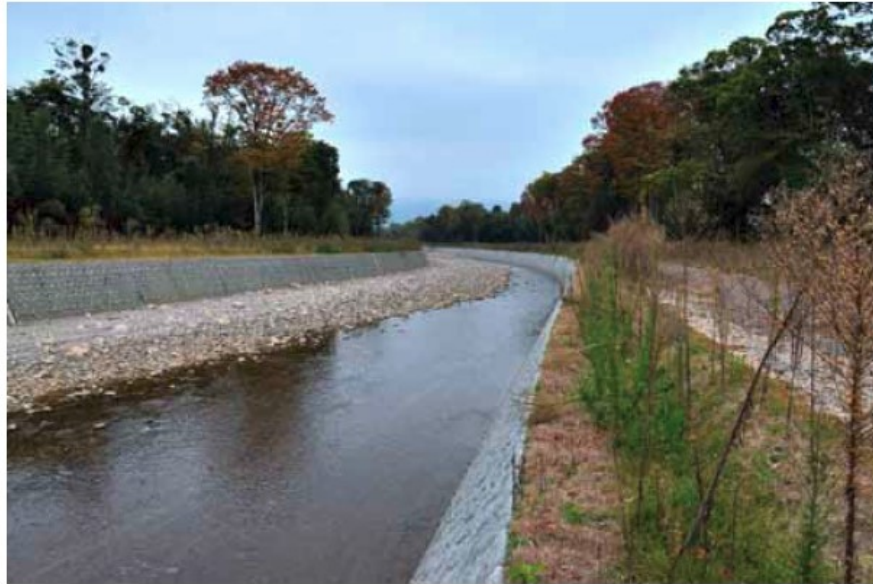
未設置進入河川的階梯與斜坡通道， 忽略了這些河川管理必要設施
