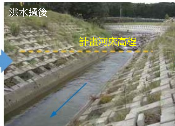
洪水過後 計畫河床高程 洪水導致覆土與填塞石塊流出，造成河床降低
