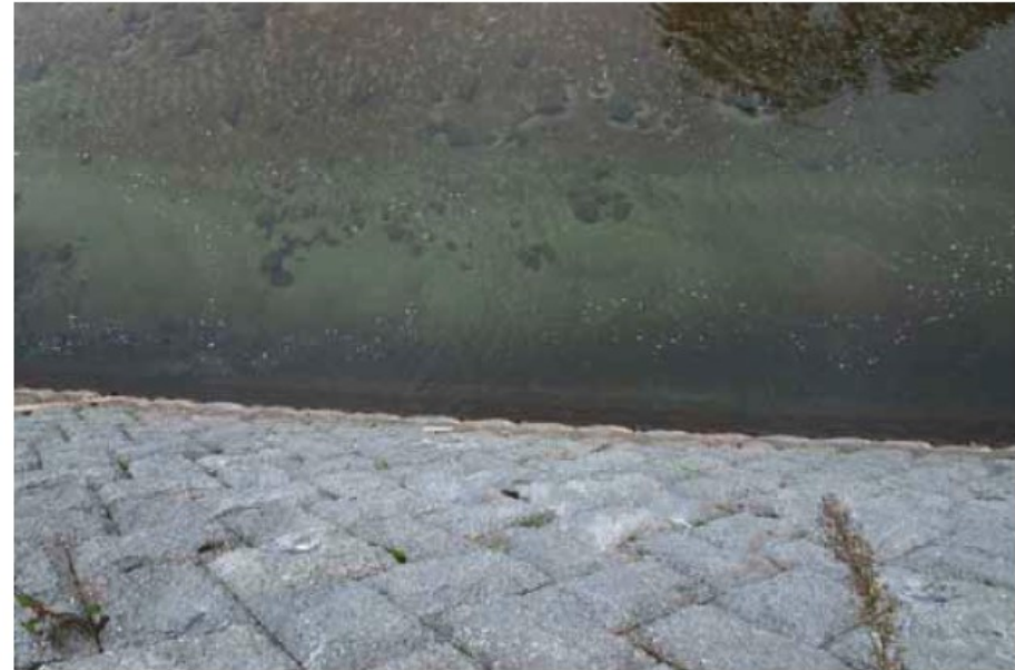
凹岸局部淘刷：基礎裸露（施工後約 2 年）
