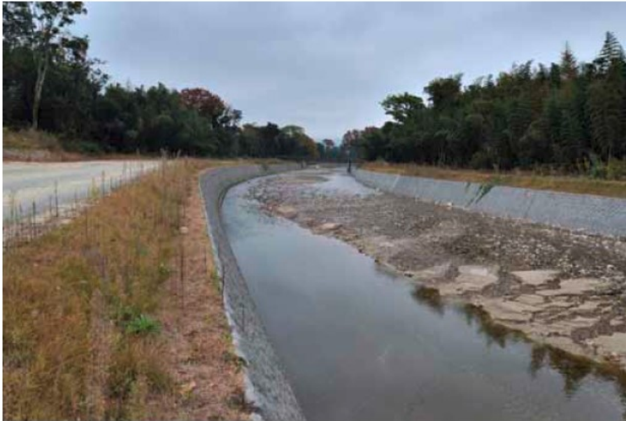
凸岸形成沙洲堆積與凹岸局部淘刷狀況
